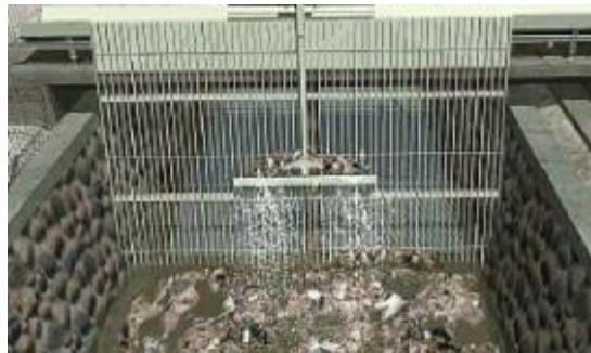
Gambar 29. Trash Rack Elektro Mekanik
